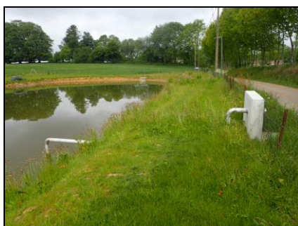
Figure 2 : Photographie d'une pompe à incendie sur une mare à Héricourt-en-caux (CABOT, 2015)
